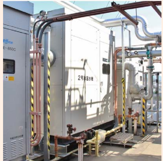
除湿用冷温水機全台更新完了(2019年8月)
