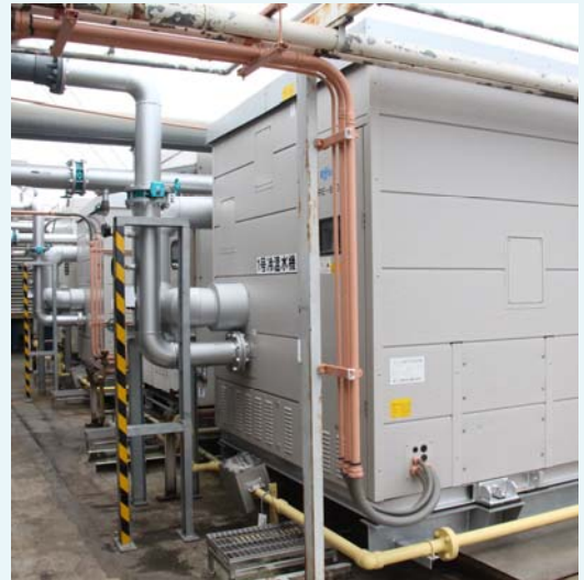
冷温水機群(2017年6月)
