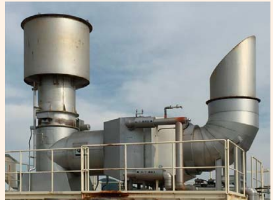
コージェネ発電機排熱回収設備
